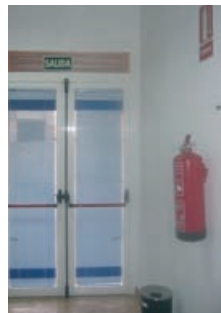
Extintor y señalización en la oficina del SEF de Archena
