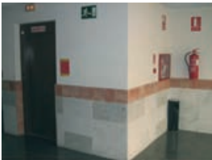
Equipos de extinción de incendios y señalización de seguridad en la oficina del SEF de Caravaca
