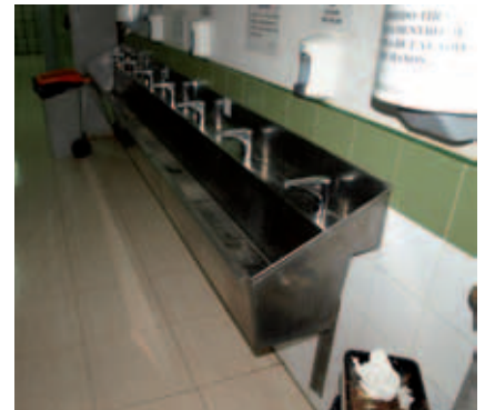
Sistema de lavado de manos no manual.
