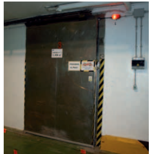
Puerta de acceso a cámara frigorífica.
